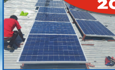
Die Solarmodule auf dem Dach zur Stromversorgung.
