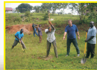
Der Bauplatz für das Kinderheim
